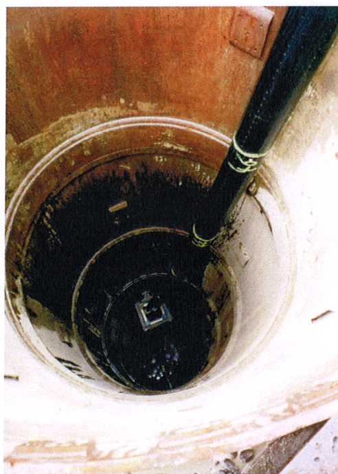
Bild 2: Führung der PEHD-Leitung im Schacht
